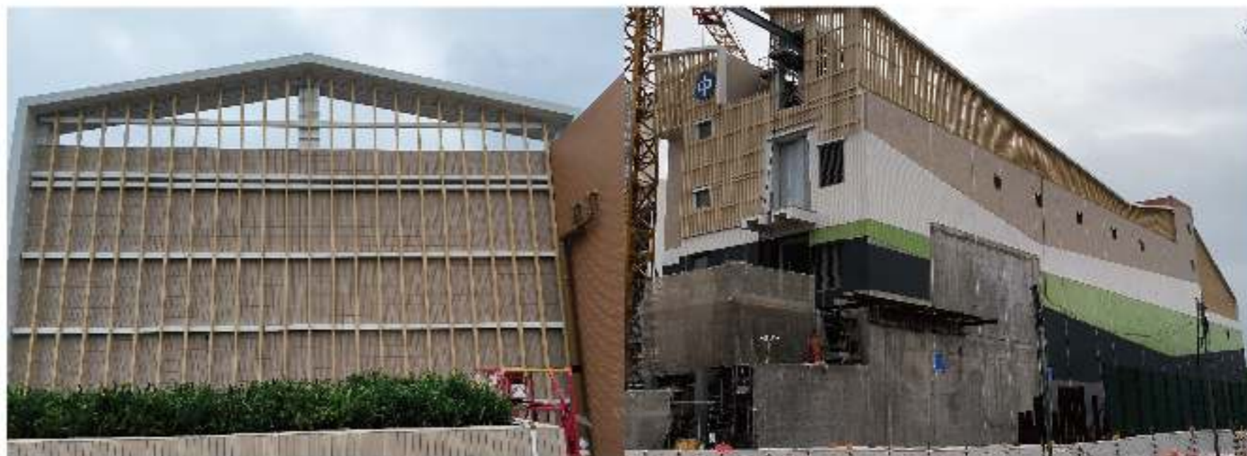
古洞北變電站 / Kwu Tung North electrical substation
